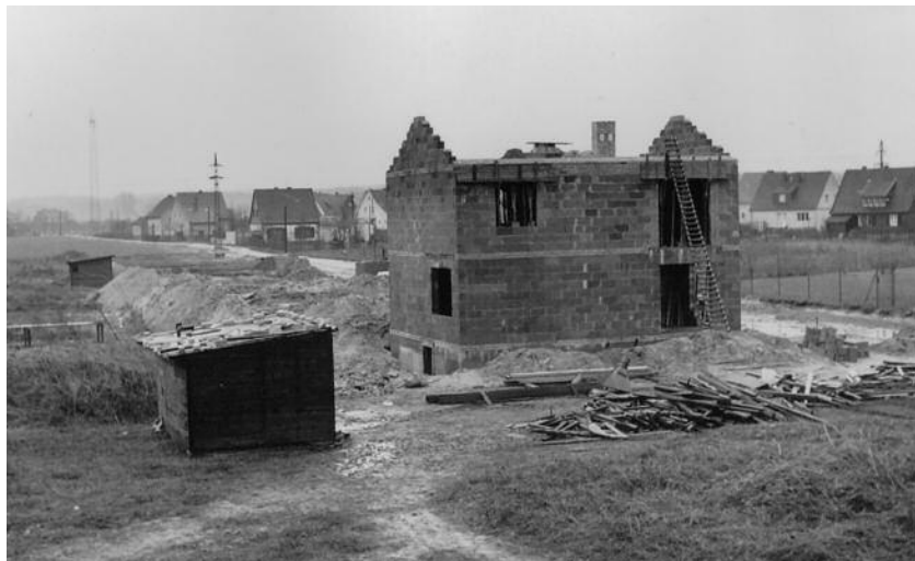
Das erste Haus (Familie Müller) ist richtfertig. Im Hintergrund Häuser an der Uhlandstraße und Matthias-Claudius-Straße/Tiefenbroicher Straße
